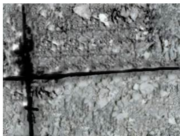
Rys. 2: Erupecja wody ze szczeliny wzdłużnej między pasem ruchu a pasem postojowym – z cząstkami drobnymi i z piaskiem z hydromielenia.
