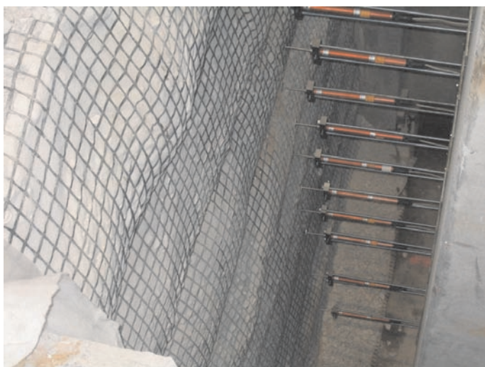
Rys. 2. Lico bloku z gruntu zbrojonego z 12 indukcyjnymi czujnikami przemieszczeń poziomych [1]
