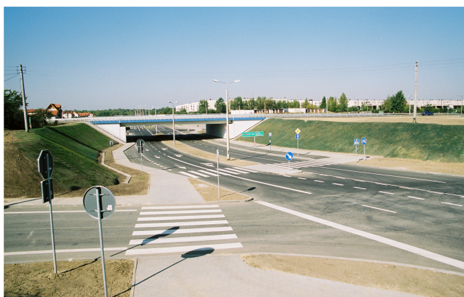
Fot. 1. Przykład prawidłowego zabezpieczenia skarp przydrożnych
